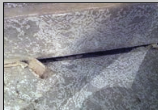
Der technisch falsche Dichtstoff. Keine Hinterfüllung.
